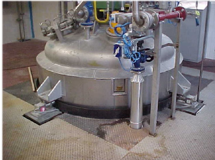
Abbildung 4: Beheizter Ansatzbehälter mit KIS-8 Wägezellen
